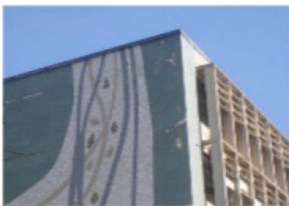
Font: IVE Fissures horitzontals per deformació de forjat de coberta
