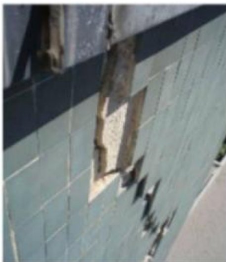
Font: IVE Lesió en façanes per falta de resistència a compressió.
